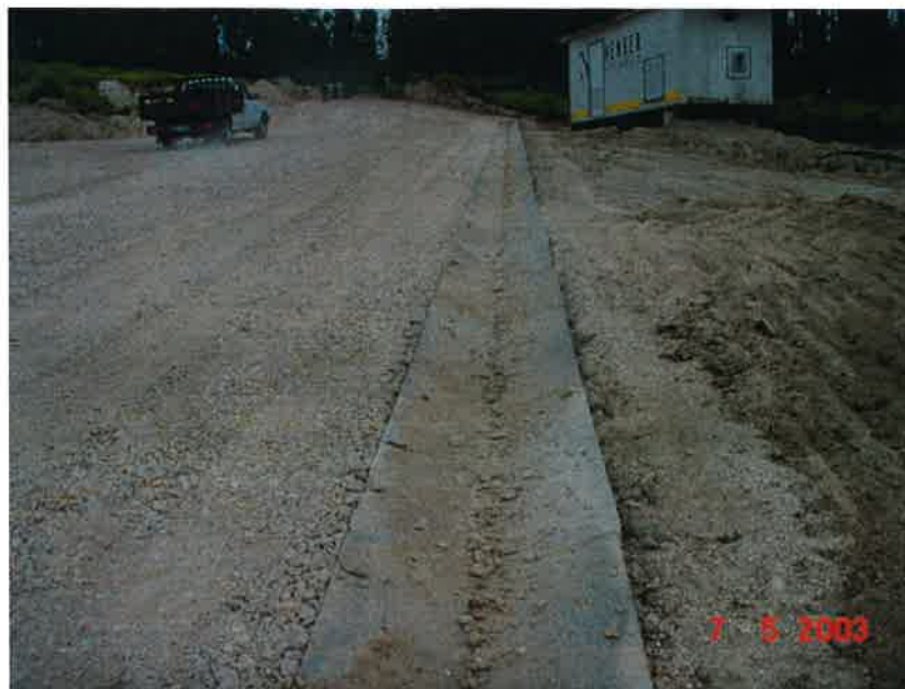
Foto 4 – Rede de drenagem pluvial
